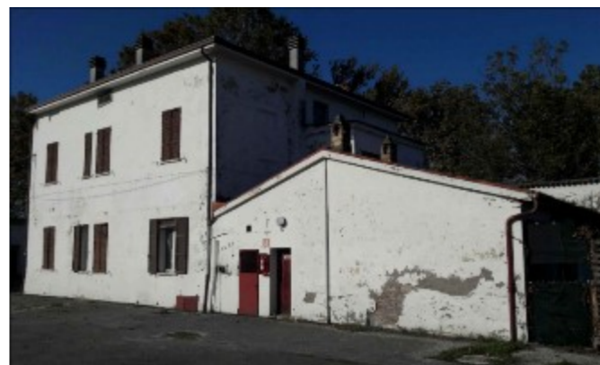
EDIFICIO 5: CASA CUSTODE. L'edificio è una casa colonica in muratura intonacata e tinteggiata, costituita da due piani fuori terra e un piano sottotetto, oltre a un magazzino di un piano fuori terra. Gli infissi esterni sono con telai in legno. La copertura, a padiglione nella porzione adibita ad abitazione e a due falde nella porzione adibita a servizi, presenta una struttura portante con orditura lignea ed uno strato superiore di finitura in laterizio.
