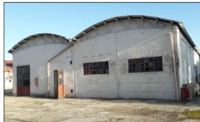
EDIFICIO 3: CELLE E SERVIZI. L'edificio è costituito da due elementi "in linea" di analogia forma, dimensione e tipologia, di un piano fuori terra. Presenta una struttura portante in cemento armato con travi e pilastri e tamponamenti laterali in pannelli prefabbricati in cls tinteggiati, e copertura voltata con manto di copertura in lamiera grecate e finitura superficiale in guaina ardesiata.
